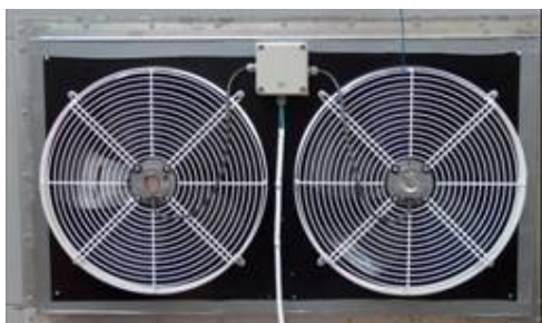
Figura 17. Ventiladores de 450mm em paralelo
