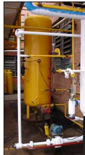
Depósito de líquido e medidor de vazão Coriolis
