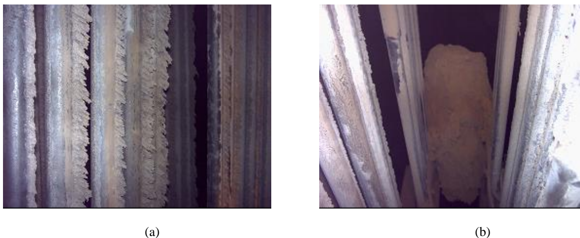
Figura 1 – Depósito de cinzas nos tubos do superaquecedor final.
