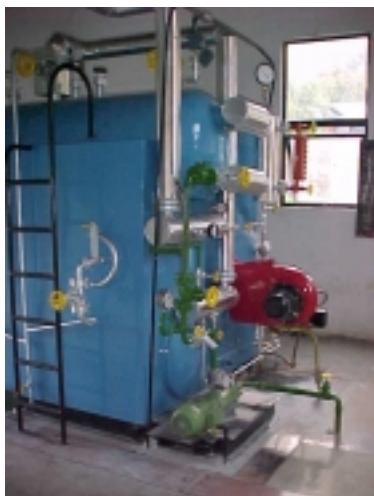
Caldeira aquotubular com queimador automático do ciclo a vapor.
