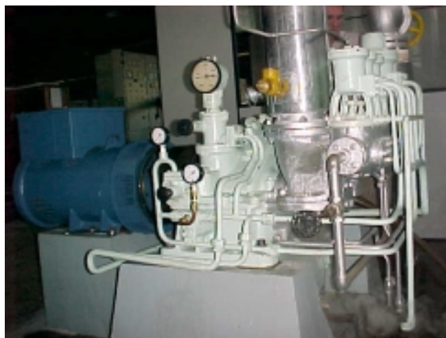
Turbina a vapor de 85 kw com o gerador elétrico.
