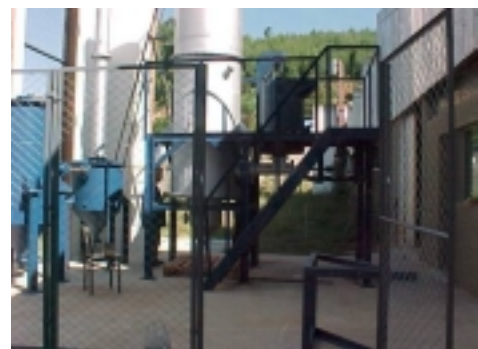
Vista do silo de biomassa, do alimentador e da seção do leito.
