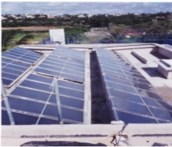
Foto 01 – Sistema de Aquecimento
