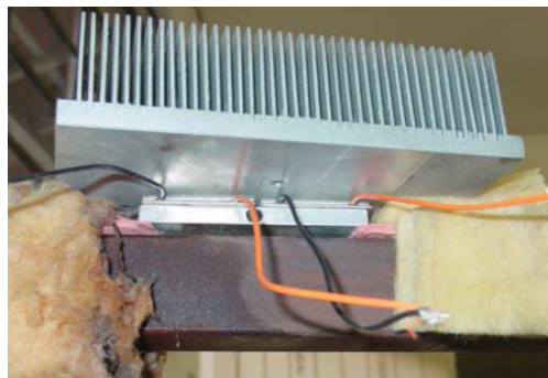
Figura 6. Módulo termoeletrônico e dissipador de calor acoplados no duto de exaustão de gases.
