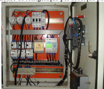
Figura 10: Quadro de comando da unidade
