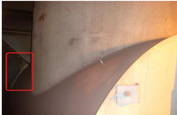
Figura 9. Imagem fotográfica da junção da câmara aviada com a parede lateral e canal de descida
