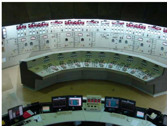
Figura 1- Sala de Operação e Controle de um Sistema de Energia Elétrica
