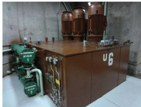
(d) Sump tank
