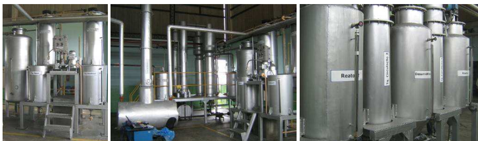
Figura 3 - Imagens internas da usina piloto de biodiesel de Caetés.
