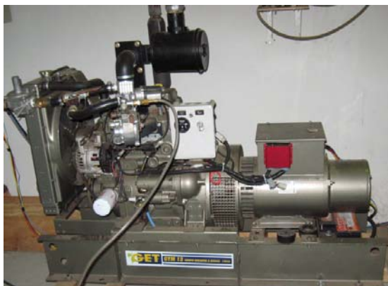
Figura 2.2 - Foto do motogerador.
