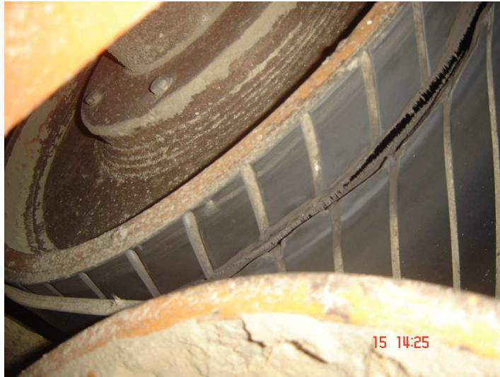
Figura 7. Detalhe da região onde ocorreu a falha no rolo motriz (2009).
