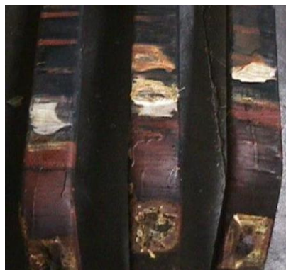
Figura 2. Barras com evidências de descargas parciais. (CESP, 2000)
